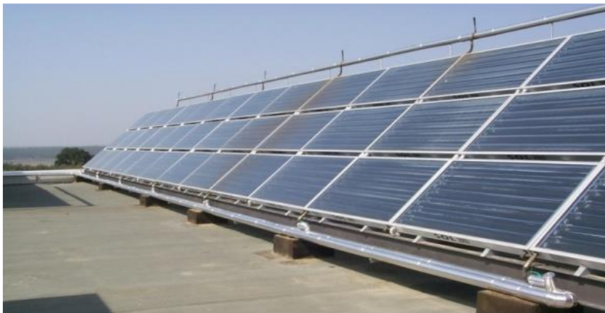
Figura 18 - Instalação de sistema solar coletivo com utilização de coletor solar do tipo CPC, na configuração de circulação forçada. (Fonte: LNEG).
