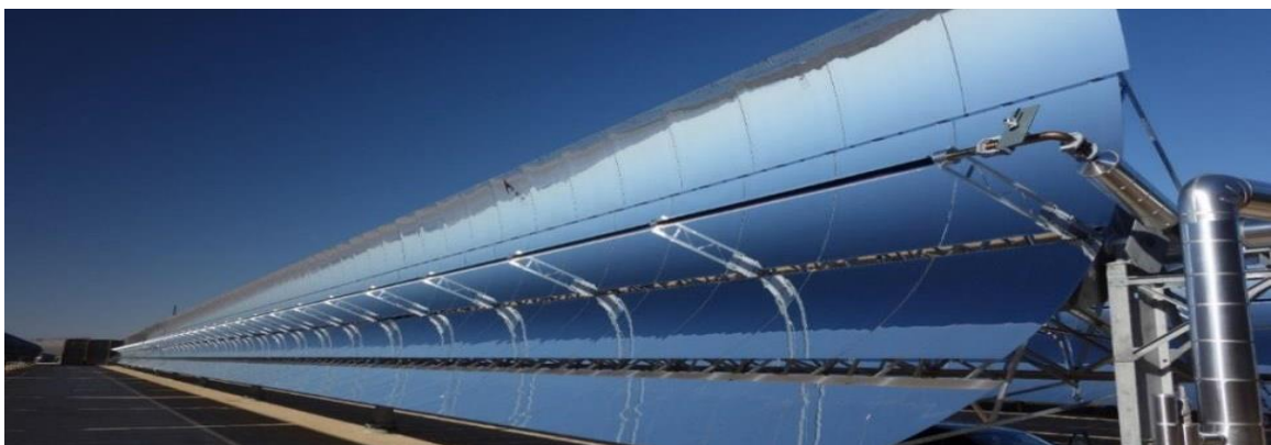
Figura 20 - Coletores cilindro parabólicos. (FLABEG, 2015).
