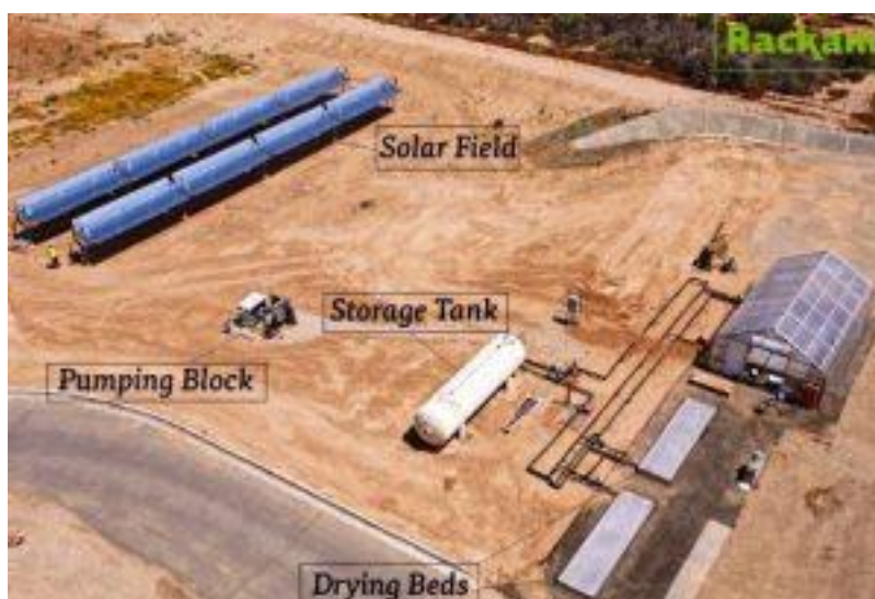
Figura A - Estação piloto para a secagem de lamas de ETAR em Surprise - Arizona (USA).
