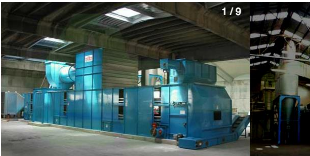
Figura F. Instalação de secagem industrial (directo de banda)
