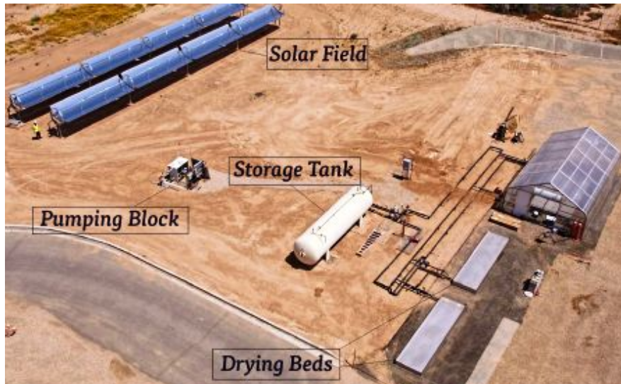
Figura 14 - Estación de tratamiento de aguas residuales utilizando los concentradores de cilindros parabólicos para el secado de los lodos
