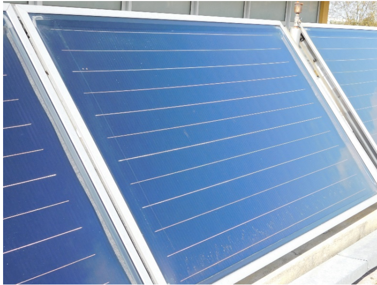
Figura 14 - Colector solar plano con absorsor selectivo. Fuente: LNEG
