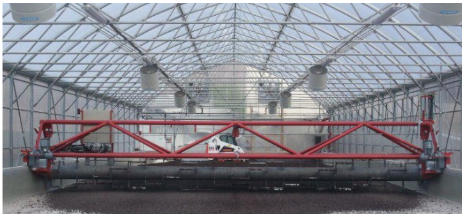
Figura C. Sistema Heliantis en el secado de lodos de EDAR da Ponta - ilha de Porto Santo.
