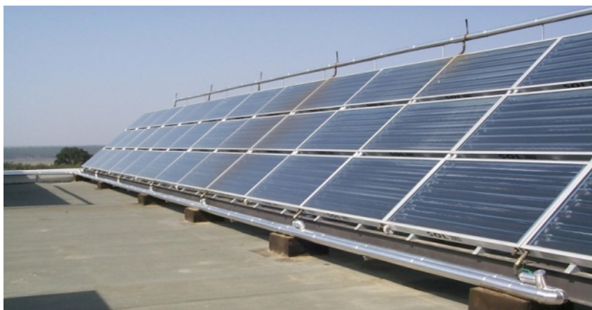
Figura 18 - Instalación de sistema solar colectivo con utilización de colector solar del tipo CPC, en la configuración de circulación forzada. (Fuente: LNEG).
