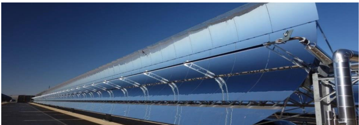
Figura 20 - Coletores cilindro parabólicos. (FLABEG, 2015).
