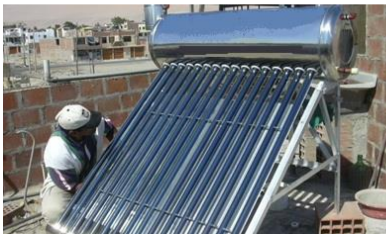
Figura 15 - Coletor de tubo de vácuo. (Fonte: LNEG).
