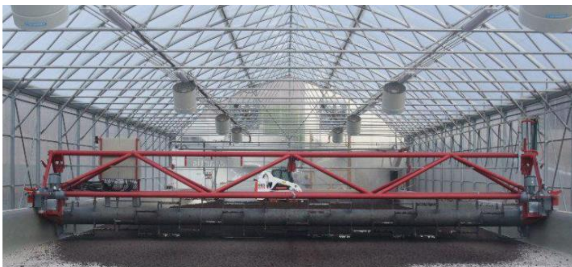
Figura C. Sistema Heliantis na secagem de lamas de ETAR da Ponta - ilha de Porto Santo.
